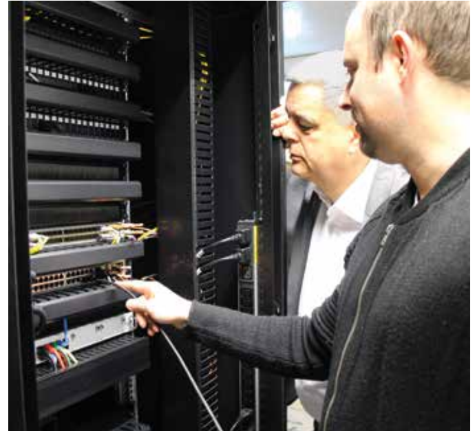
André Ehrhardt, Abteilungsleiter IT & Transport-Logistik der BÄKO-ZENTRALE eG mit Systemadministrator Matthias Plisz im Serverraum unseres Rechenzentrums
